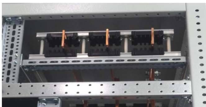
Рисунок 4.3 – Отсек горизонтальных сборных шин
